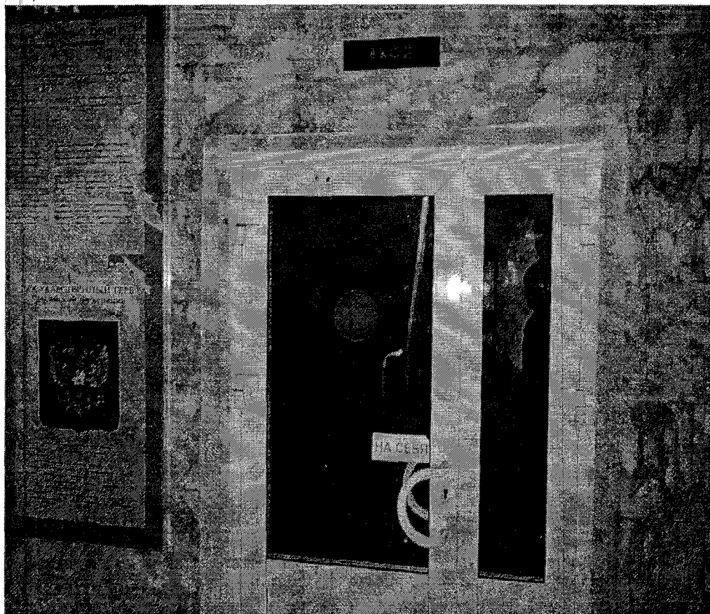
Дверь (на лестницу) – Фото №39
